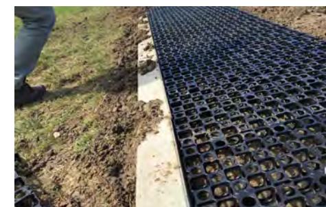
Voorbeelden van aangebrachte horizontale overgangen op de pilotlocatie. In de komende jaren zal het gras door de versterkingsmaatregel heen groeien.
