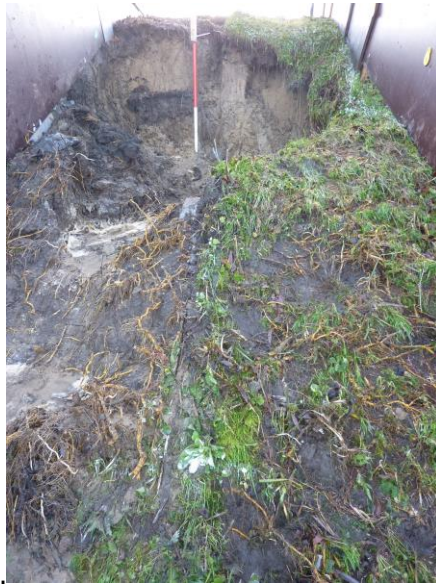
Figuur 15 Overzicht schade talud na afloop overloop proef 30 l/s per meter (Vak A links, Vak B rechts)
