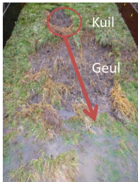
Figuur 13 Overzicht schade talud na 1 uur 25 l/s per meter
