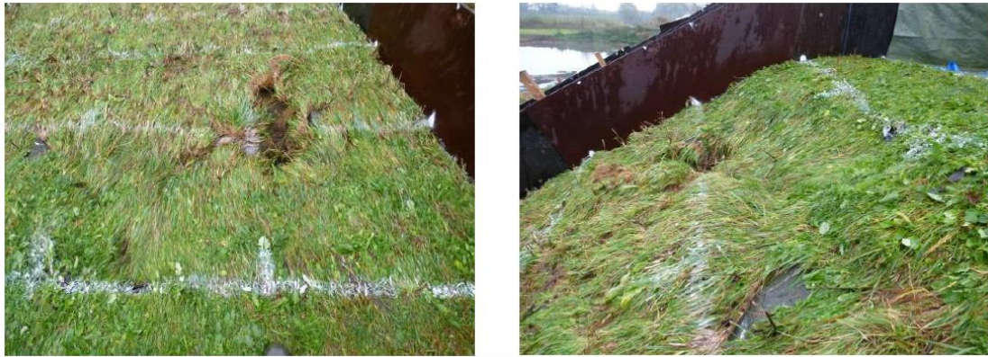
Figuur 9 Gat rechts onderin subvak 4A en bovenin 5A (bron: INFRAM, 2015).
